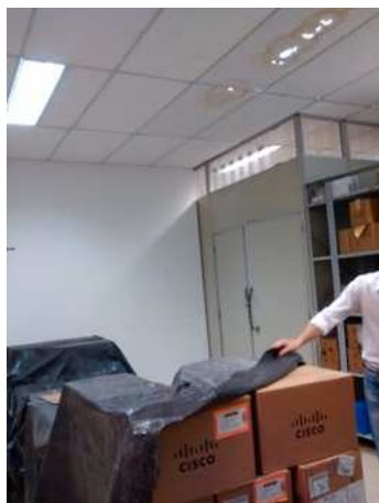
Detalhe do forro do teto de sala climatizada danificado por goteiras e materiais protegidos com sacos plásticos.
